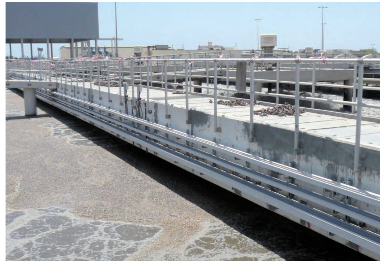
Tratamento de águas: ETAR
