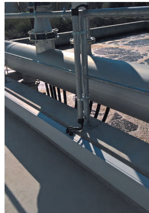
Tratamento de águas: ETAR
