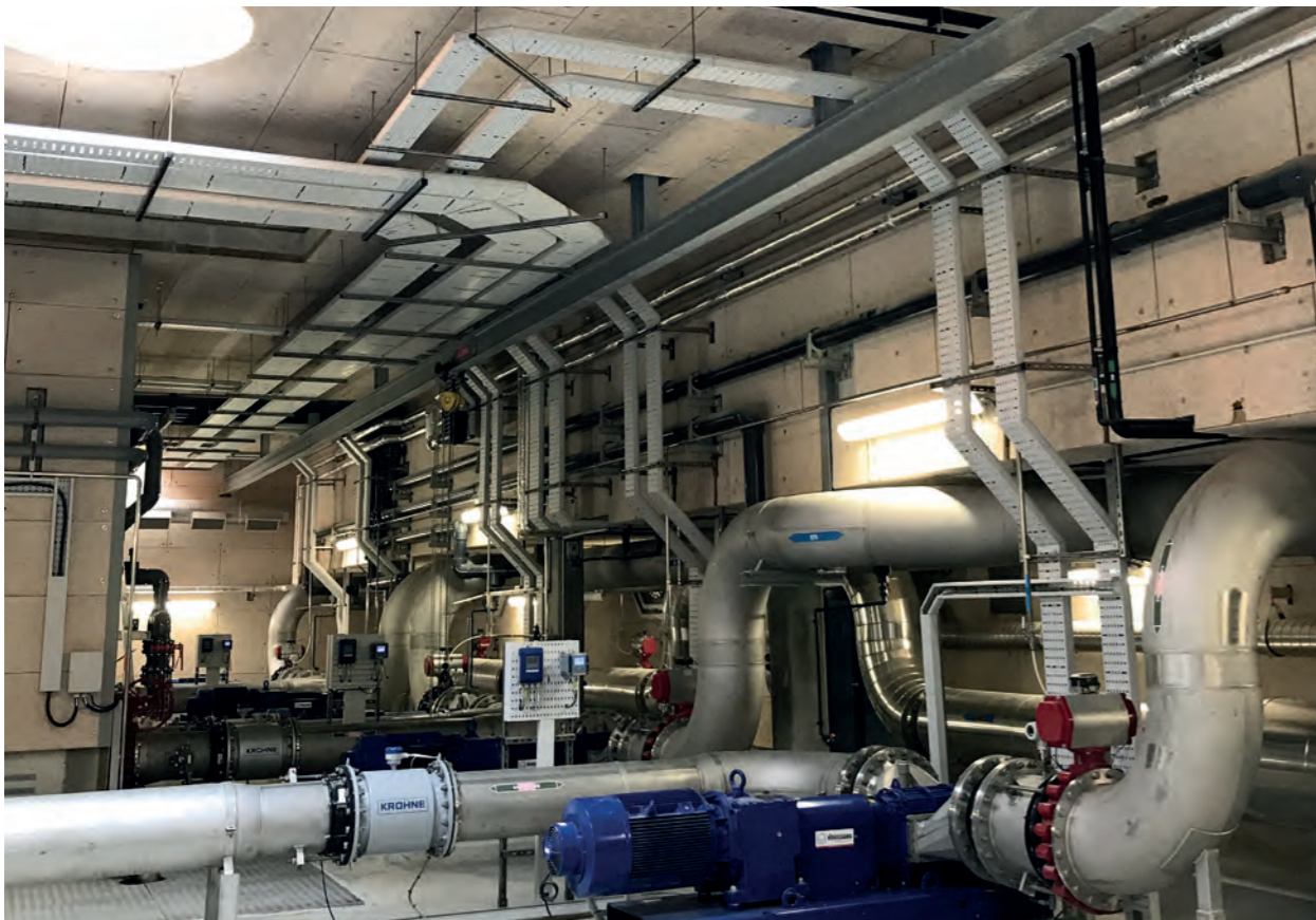
Tratamento de águas: ETAR
