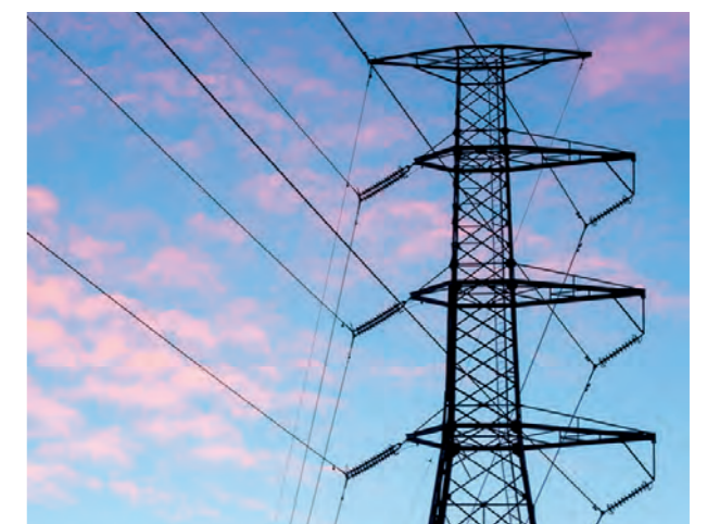
Redes de distribuição de energia elétrica
