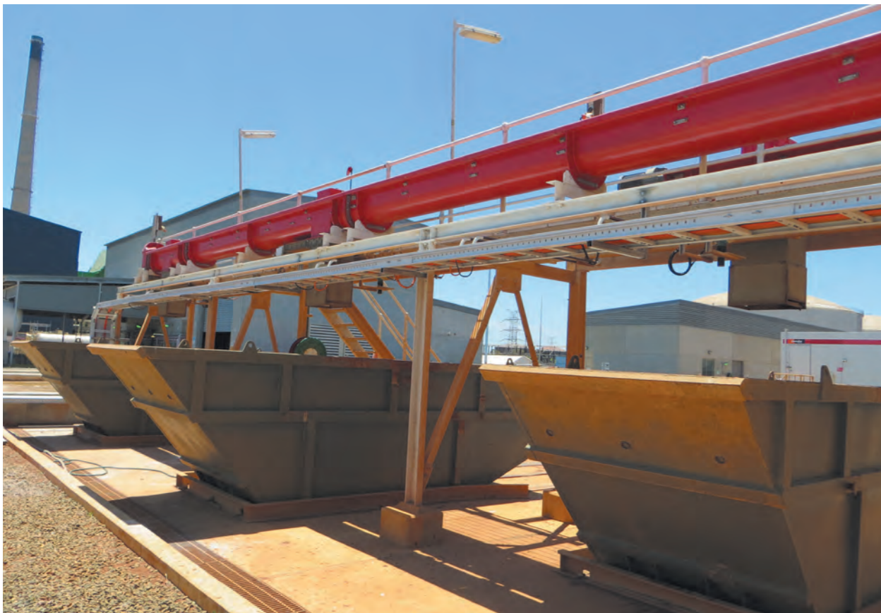
Tratamento de águas: estação dessalinizadora
